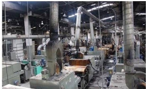
Lớp cách nhiệt trong xưởng của công ty Vina Wood bị cháy gần như toàn bộ và máy móc bên dưới bị cháy thành các vùng riêng biệt do lớp cách nhiệt cháy rơi xuống
